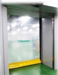
空調効率対策 シャッター(作業棟)
