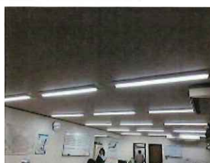
事務所の様子（LED照明）
