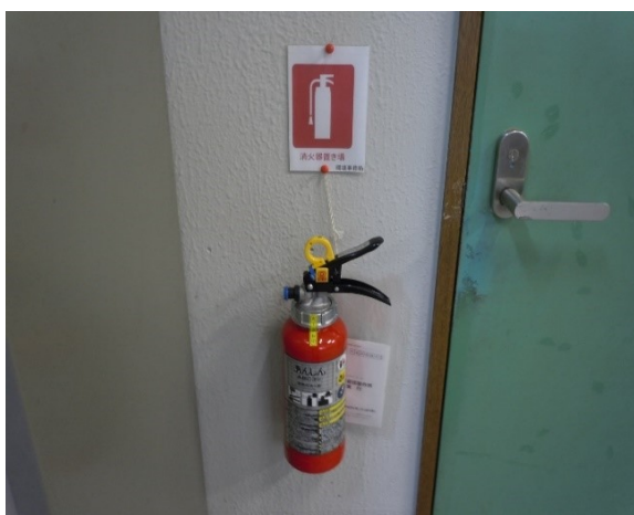
<消火器置場掲示板>
