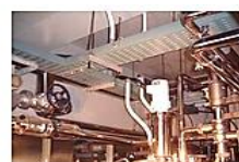
プラント設備施工例②
