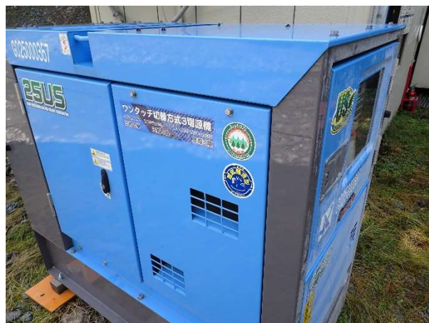
排ガス低排出、低騒音、防油堤の活用
