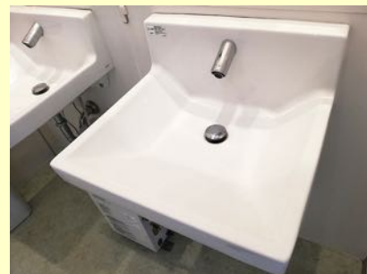
自動水栓の使用
