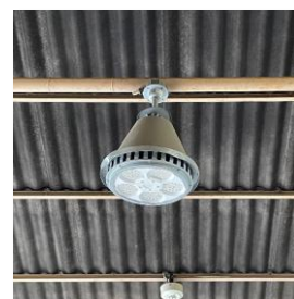
LED照明の積極導入 倉庫、事務所の照明のLED化
