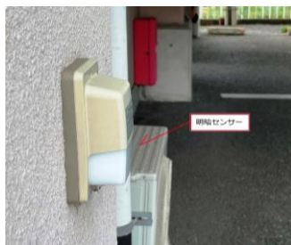
駐車場照明の点灯コントロール 夜間のみオートON
