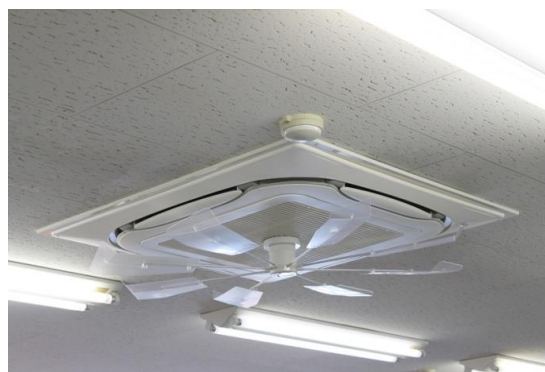
1F・2F・3Fの大型エアコンにハイブリットファンを設置 ※冷暖房の温度むらを攪拌、空調効率の向上のため
