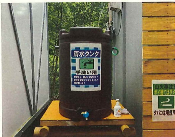
山間地現場事務所での雨水利用
