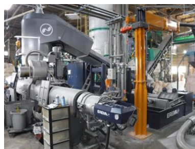
【定期的な設備更新】
