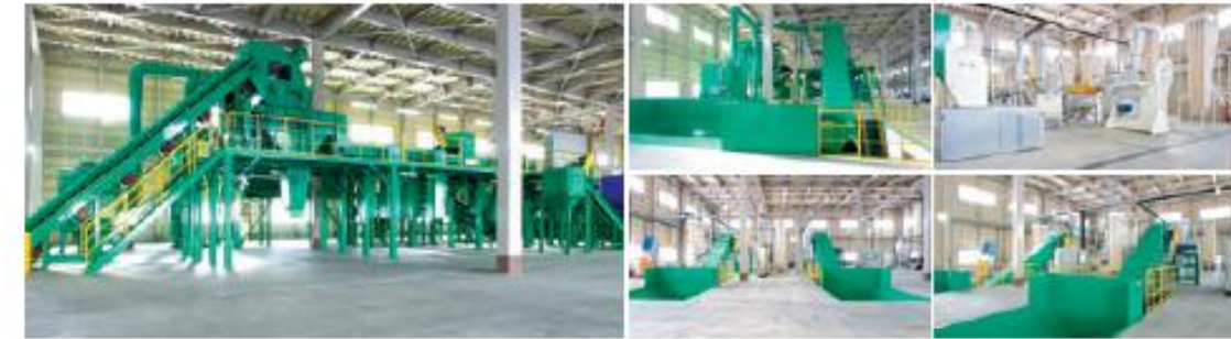
プラスチック再生施設
