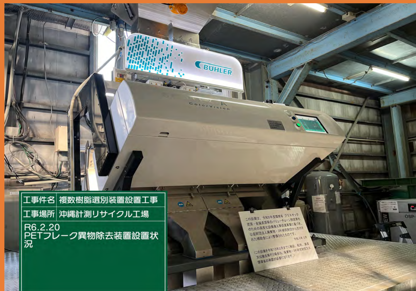
フレークソーター設置状況
