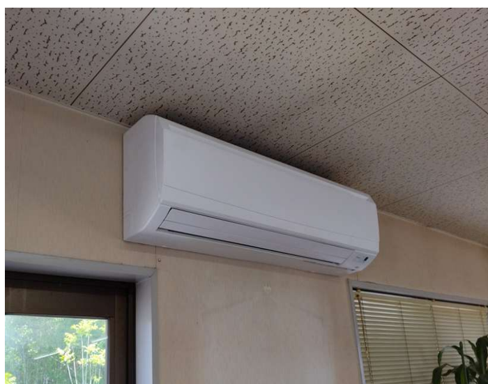
●新型エアコン設置
