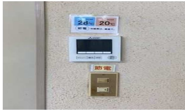
事務所及び執務室 節電・エアコン設定
