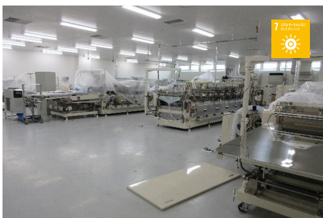
▲工場の蛍光灯の全LED化（写真：関西工場）
