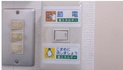
節電ステッカー貼付 (平成22年12月設置)
