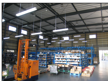
○大阪…倉庫照明を水銀灯から蛍光灯へ変更
