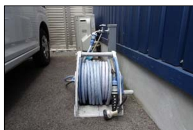
【本社】(駐車場)散水ノズルを使用
