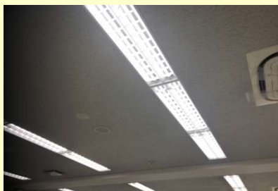
事務所内 LED 照明
