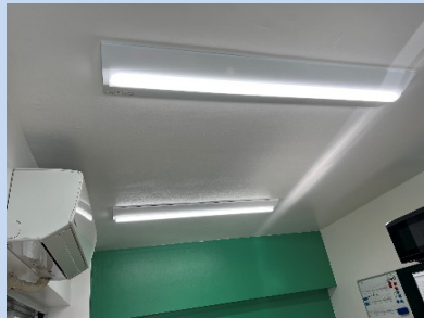
第一休憩室（LED照明）
