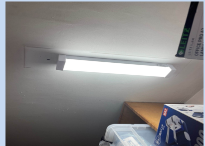
事務所倉庫（LED照明）
