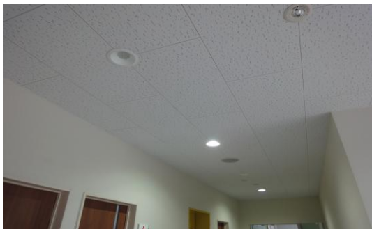
廊下・トイレ自動点滅
