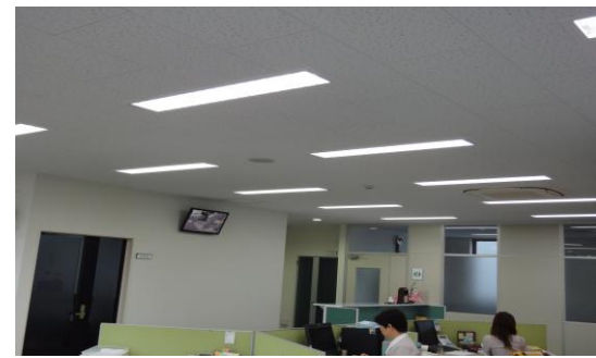
事務室のLED照明
