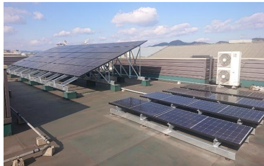
本社太陽光発電、蓄電池
