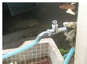
(節水表示)外水道
