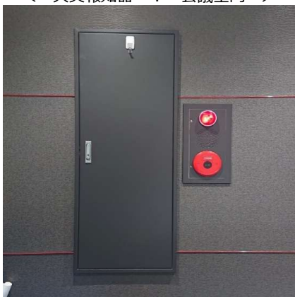
< 火災報知器 : 会議室内 >
