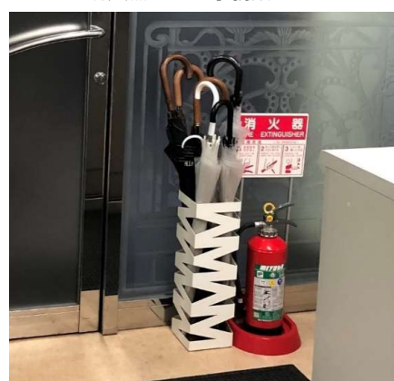
< 消火器 : 事務所入口 >
