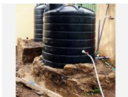
ケニアに設置された水のろ過槽
