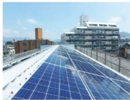
LAセンター 屋上の太陽光パネル
