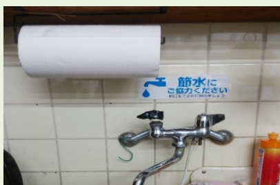
水使用場所に節水プレート設置
