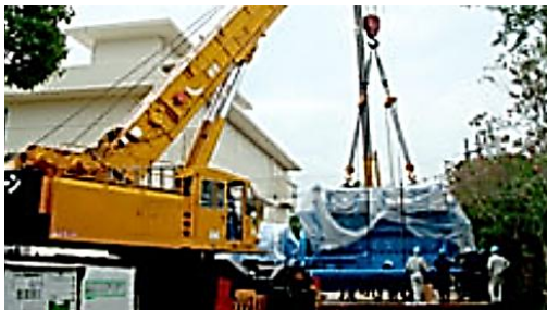
奈良県浄化センター 分散型電源源 (DG3000KVA)
