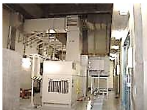
ガスタービン発電装置 1500kVA
