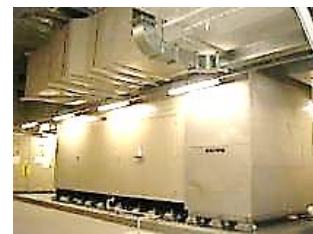
非常用電源装置 6000kVA
