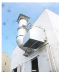
エンジン排気ダクト
