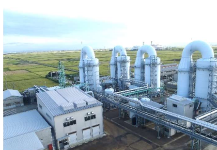
【ヨウ素製造設備】
