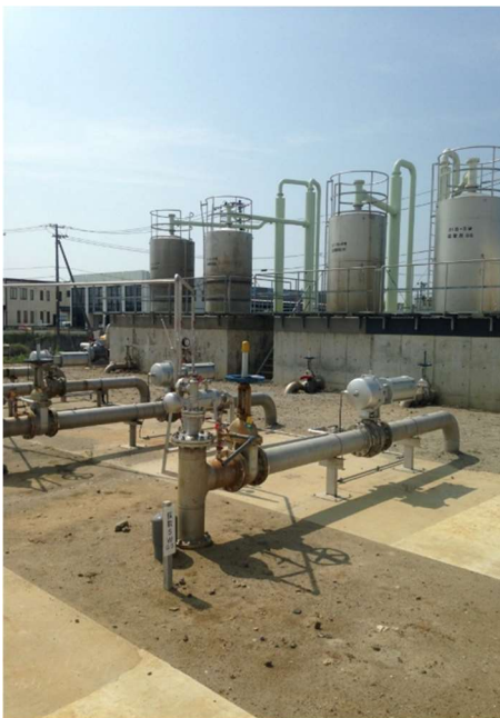
【天然ガス採取設備】
