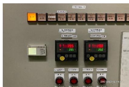
電力量測定器設置
