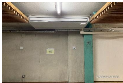
印刷室空調更新
