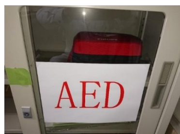
現場事務所にAEDの設置
