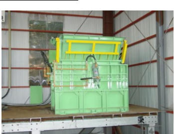
＜一軸破碎機＞本社 産廃施設【破碎施設】固定式
