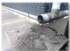
雨樋から貯水槽へ
