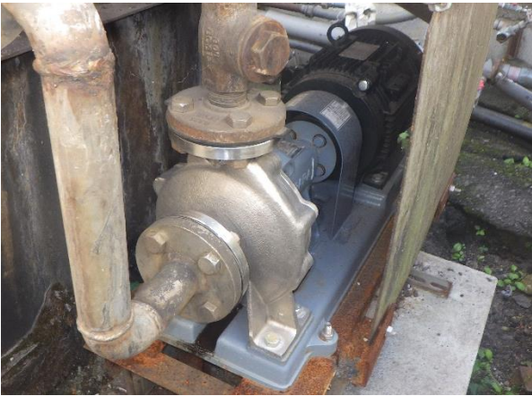
冷却洗浄ポンプ
