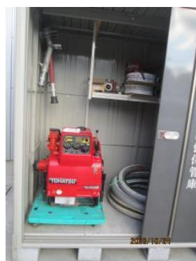
保管庫内のポンプ
