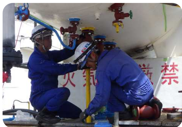
LNGタンク定期検査②
