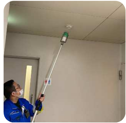
消防設備点検
