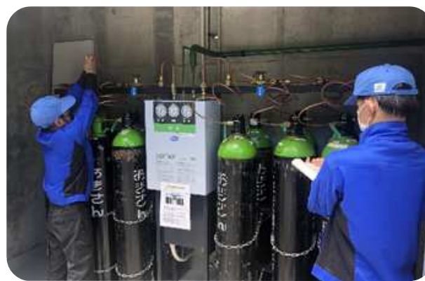
医療ガス供給設備 (メンテナンス)
