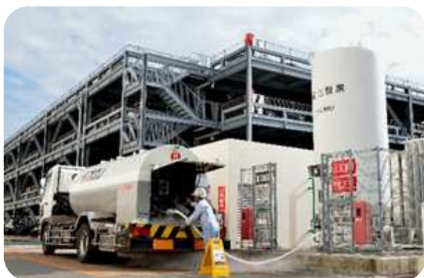
医療ガス供給設備 (液化酸素貯槽)
