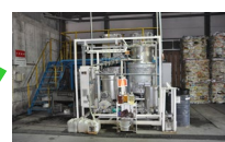
代替燃料製造装置
