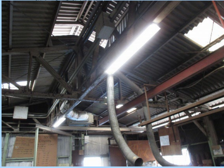
室内機(更新前)
