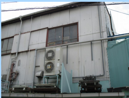
室外機(更新前)
