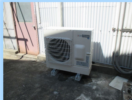
室外機(更新後)
