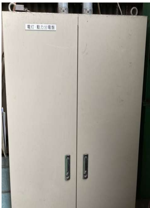
省エネ電灯・電動分電盤
