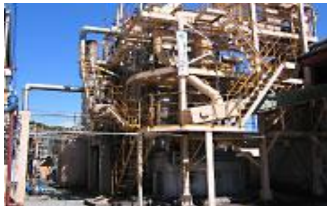
③ 発電設備
