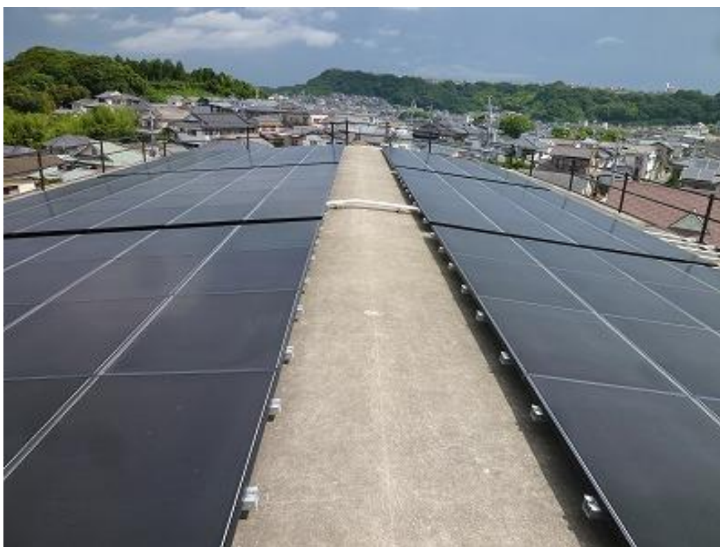
資材倉庫屋上に設置した太陽光パネル（平成26年3月）
