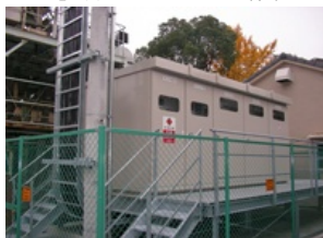
〔受変電設備改修〕 トッランナー機器へ
