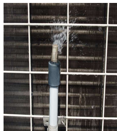
空調室外機への散水（拡大）
