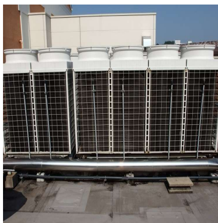
空調室外機への散水
