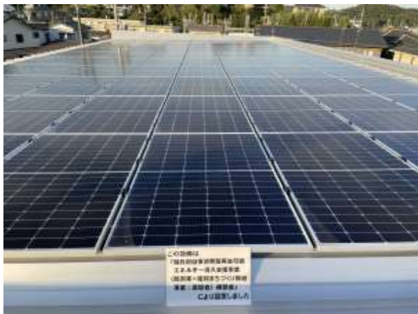
太陽光パネル
