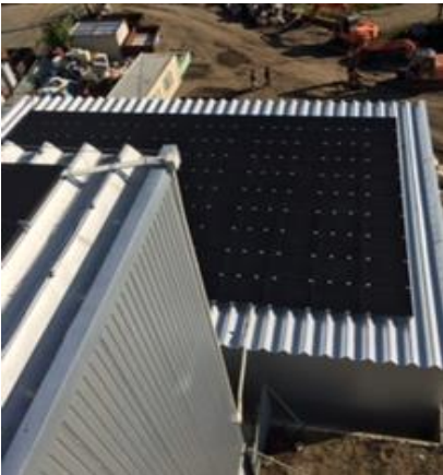
産業廃棄物保管施設のソーラーパネル
