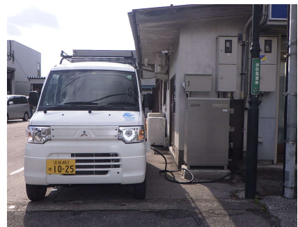
EV・PHV用充電設備
