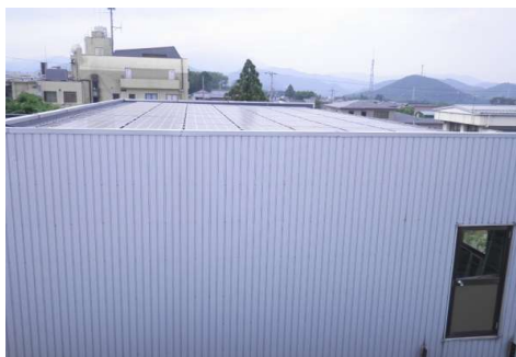
太陽光発電（南側倉庫）
