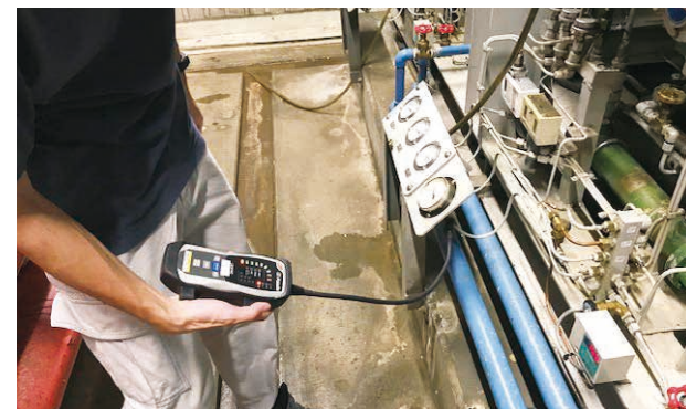
冷媒漏えい点検
