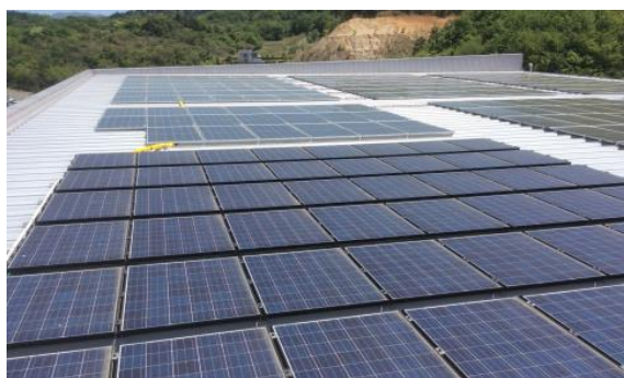
【工場屋上設置の太陽光パネル写真】
