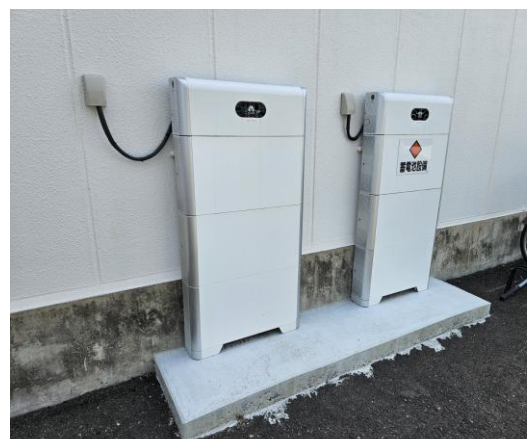
【太陽光発電装置蓄電池写真】
