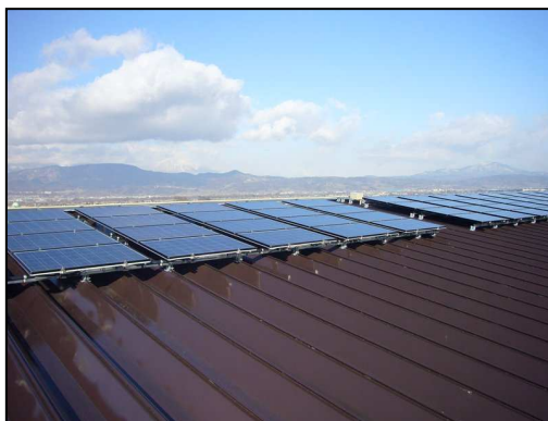
※太陽光発電システムモジュール 設置例
