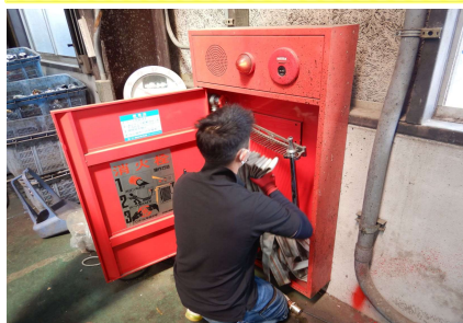
工場消火栓自主点検実施しました
