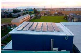
社屋屋上の太陽光パネル
