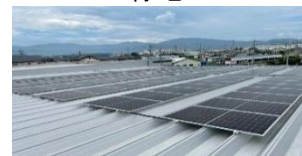
太陽光発電システム
